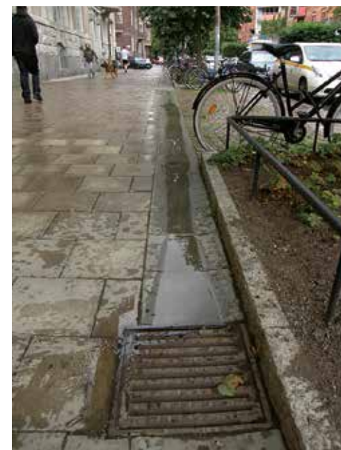
Dagvattenränna med luftningsbrunn kopplad till växtbädd.
