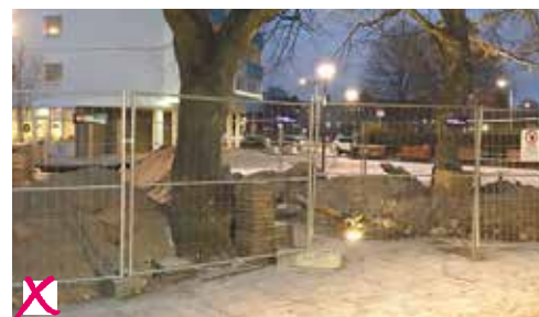
Ingen avspärning: upplag och entreprenadstaket inom rotzonen.
