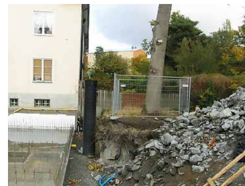
Alla träd är inte möjliga att spara vid nybyggnation. Detta träd har ingen chans att överleva.
