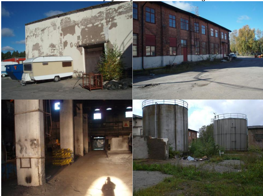
Figur 3 Foton på kontaminerade/förfallna byggnader och anläggningar.
